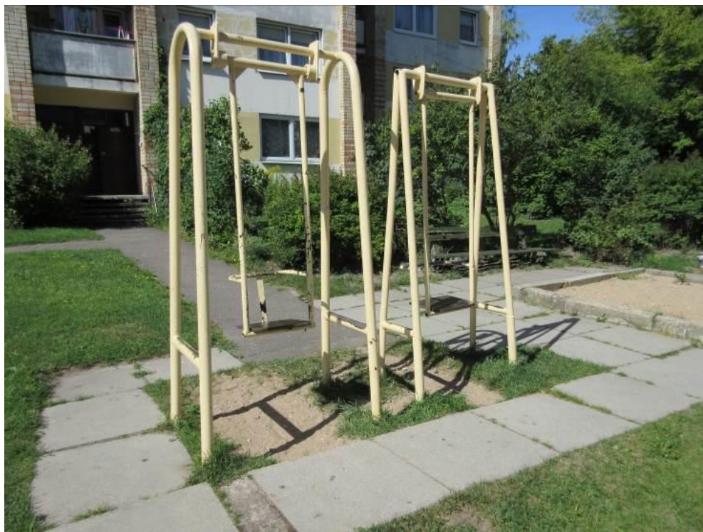
5.att. Šūpoles ar neatbilstībām
